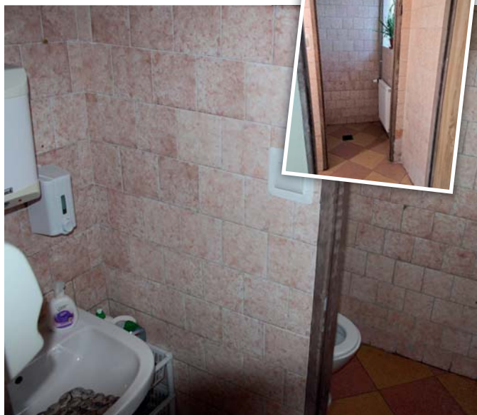
Zdjęcia toalet PRZED remontem:
