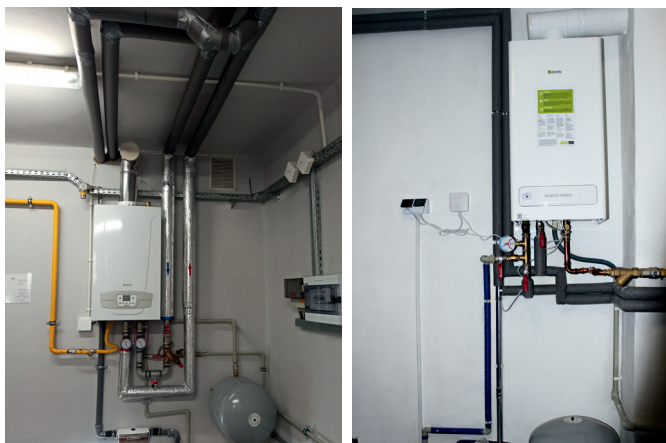
Nowe kotłownie gazowe w Przedszkolu w Bolesławiu (po lewej) i Gminnej Bibliotece Publicznej w Bolesławiu (po prawej)
