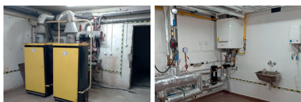
Kotłownia przed i po modernizacji
