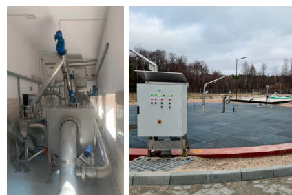
Infrastruktura oczyszczalni po rozbudowie
