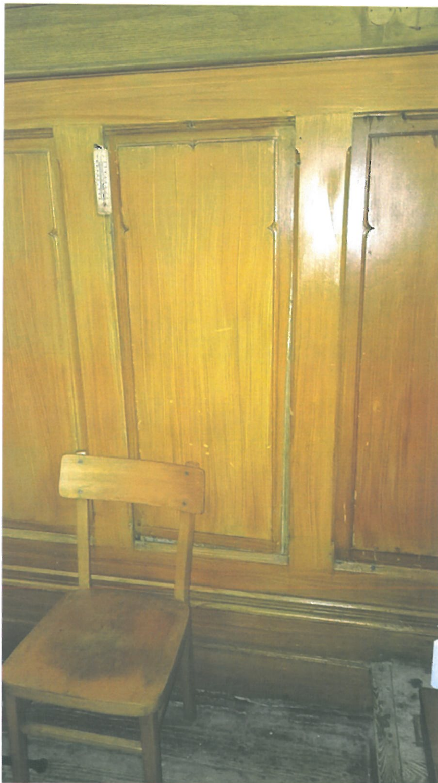
Fot. 20. Bolestaw, Kościół parafialny p.w. Macierzyństwa N M P i Św. Michała Archanioła. Bok przemalowanej wtórnie płycinowej podbudowy. Widoczna dyslokacja płyciny.
