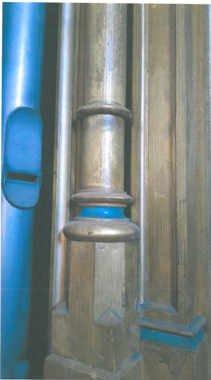
Fot. 17. Bolesław, Kościół parafialny p.w. Macierzyństwa N M P i Św. Michała Archanioła. Fragment prospektu organowego, kolumniki przy segmencie pomiędzy wieżami. Widoczne mocne zabrudzenia powierzchni, wtórne powłoki pociemniałego, niestarannie położonego lakieru na bazie szelaku miejscami poprzecierane.
